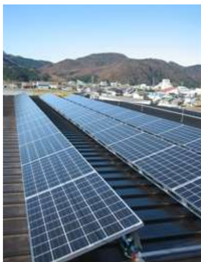
図 2-12 姫川コミュニティスポーツセンターに設置された太陽光発電設備
